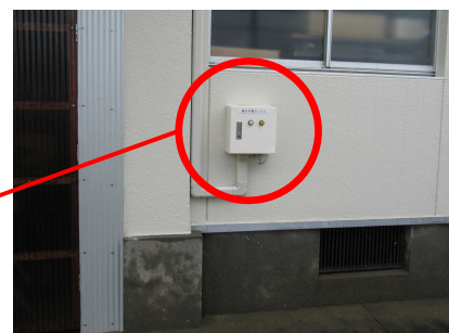
屋外中継ボックス （南東側付近）
