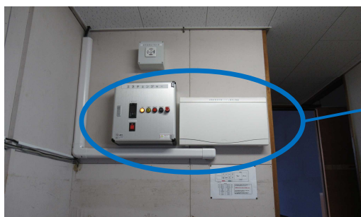
コントロールボックス・専用分電盤 （南側控室（体育館1階））
